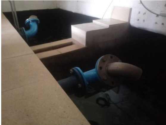
Abbildung 1: WVA Waldegg, Hochbehälter Wopfing, Blick zu den Behälterkammerzuläufen.
