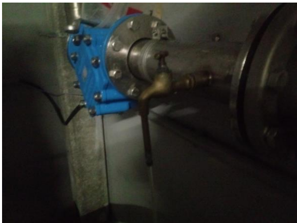
Abbildung 6: WVA Waldegg, Gerät zur Desinfektion von Wasser mittels Ultraviolettstrahlung Kressenbrgquellen, Blick zur Probenahmestelle vor Desinfektion (Probe E2201545/003).
