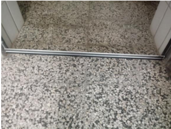
Abbildung 5: WVA Waldegg, Hochbehälter Waldegg, Blick zur Abdichtungsleiste im Eingangsbereich zu den Wasserkammern.
