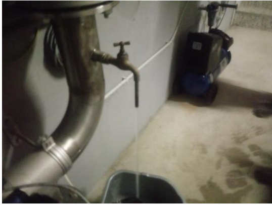
Abbildung 7: WVA Waldegg, Gerät zur Desinfektion von Wasser mittels Ultraviolettstrahlung Kressenbrgquellen, Blick zur Probenahmestelle nach Desinfektion (Probe E2201545/004).
