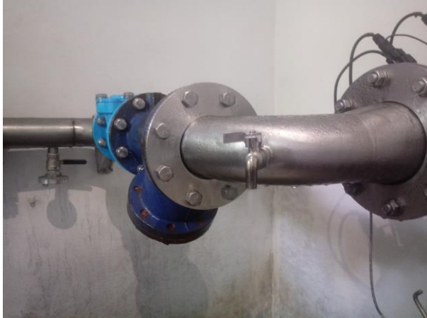
Abbildung 4: WVA Waldegg, Hochbehälter Wopfing, Gerät zur Desinfektion von Wasser mittels Ultraviolettstrahlung Dörrenbergquelle, Blick zur Probenahmestelle nach Desinfektion (Probe E2201545/002).
